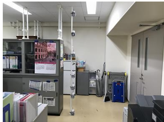
図-1 CO 2 センサー設置の様子
