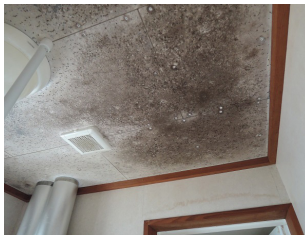
写真-2 カビ発生状況
