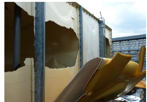
写真-1 バルジングによる高置水槽側面の損壊(富谷市内)
