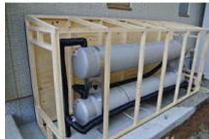
図-12 既存家屋屋外設置例
