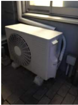
写真-3 測定点②室外機
