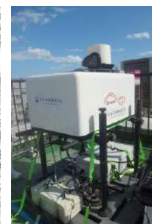
図-3 ライダー設置状況
