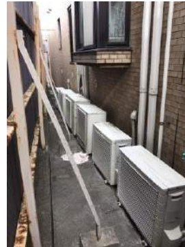
写真-5 住宅A 室外機
