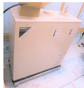
写真-1 GSHP 本体
